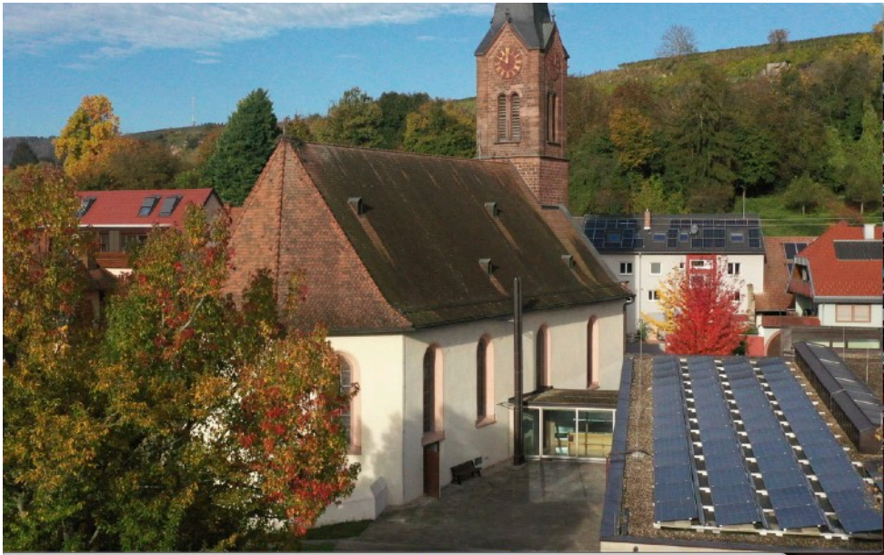
Oben: Photovoltaikanlage auf dem Dach unseres Gemeindehauses (Aufnahme: Fritz Breisacher)
